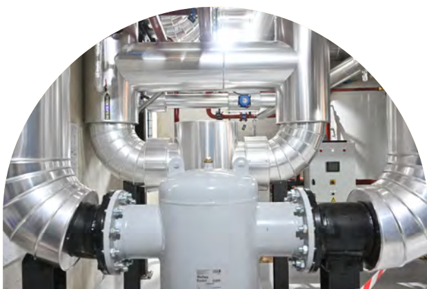
Centrale Géothermie - quartier Pleyel
