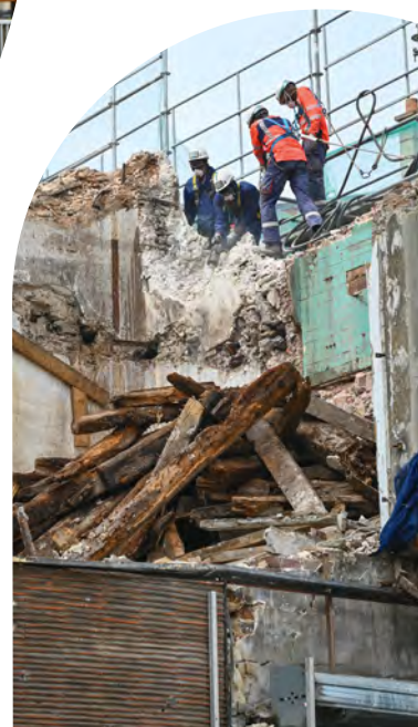
Destruction de l'immeuble au 15 place Victor Hugo
